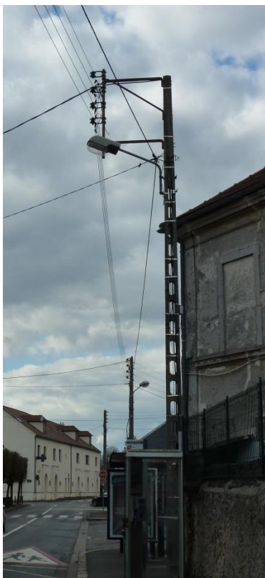
Éclairage public BT sur support béton commun
