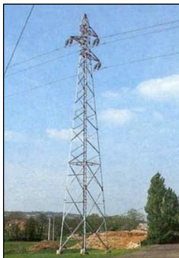
Réseau aérien HTB de 63 kV sur pylône
