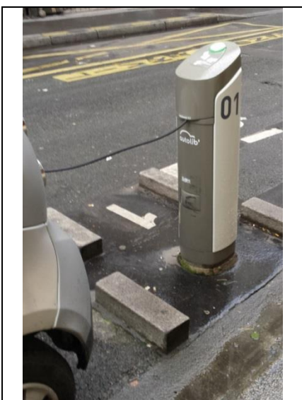
Borne de recharge électrique
