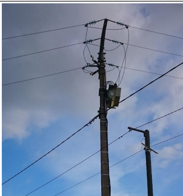
Réseau aérien BT torsadé sur support HTA
