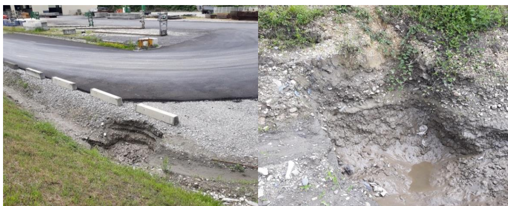
Figure 1 : Exemples de dommages sur digues, dus à l'homme, suite à travaux à proximité de l'ouvrage, sur pied de digue côté terre
