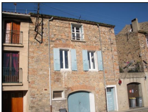
Réseau aérien BT à conducteurs nus en façade
