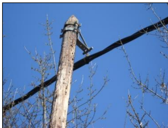
Réseau aérien HTA à conducteurs isolés sur poteau bois
